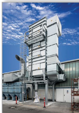
Schuko Filteranlage speziell für eine Carbonstaub-Absaugung; Fotograf: Rainer Bez
